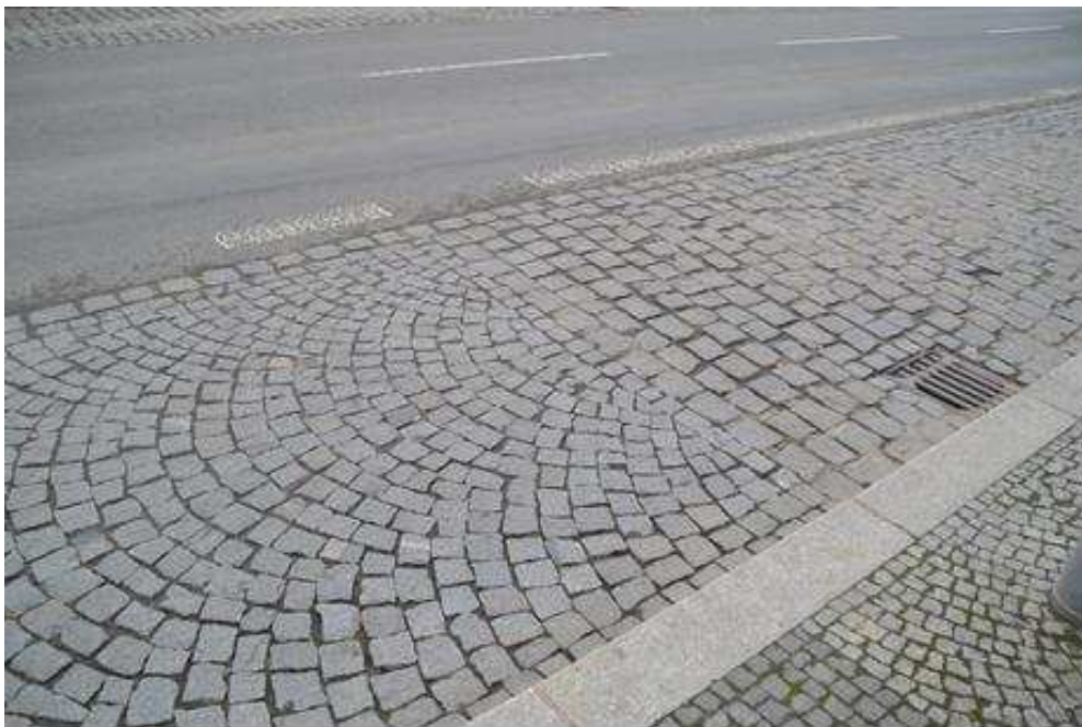
Ulice Sobotecká, detail dlažby autobusového zálivu, foto IP 2016.
