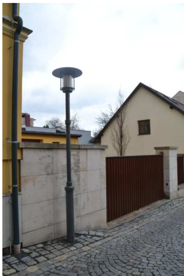
Ulice Tázlerova, detail dlažby a nevhodného oplocení u křižovatky s Vejřichovou ulicí, foto IP 2016.
